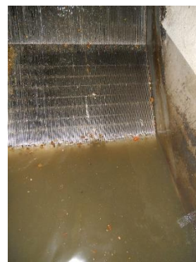
Foto: Abwasser im Zulauf der Kläranlage
